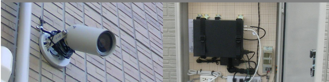
集合住宅用監視カメラシステム
