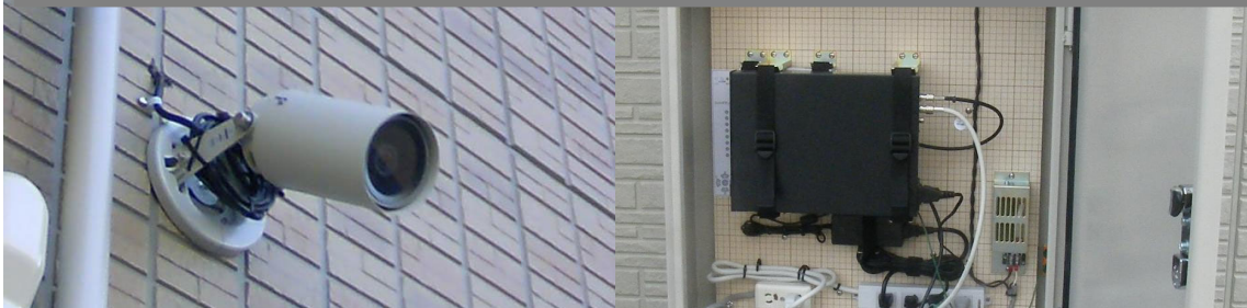
集合住宅用監視カメラシステム
