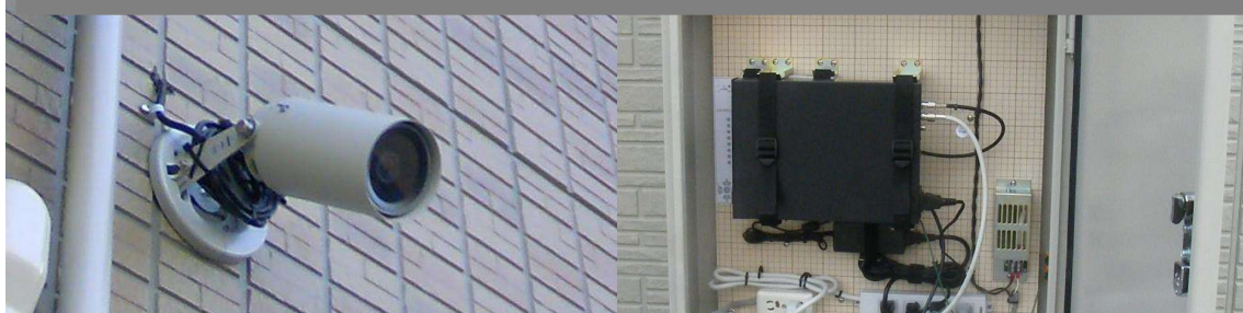
集合住宅用監視カメラシステム
